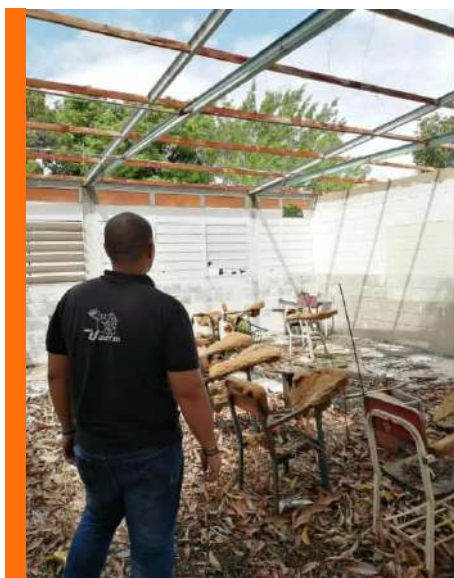
Daños en las instalaciones.
