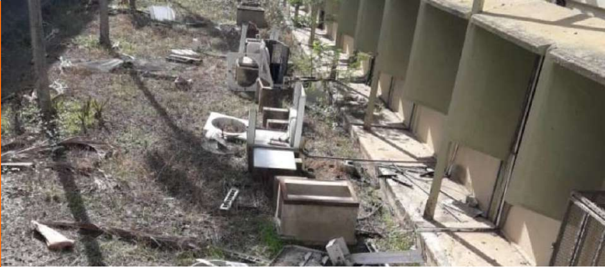
Desvalijamiento de instalaciones.
